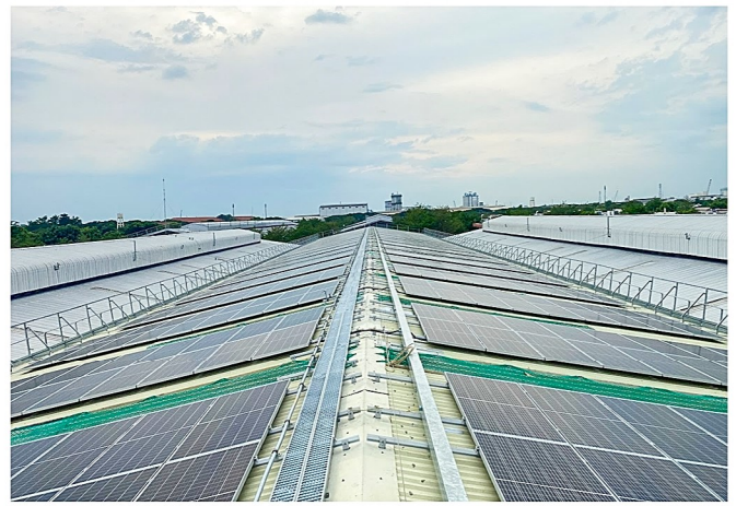
Dự án điện mặt trời áp mái 1 Mwp Công ty TNHH Đầu tư An Phú Solar
