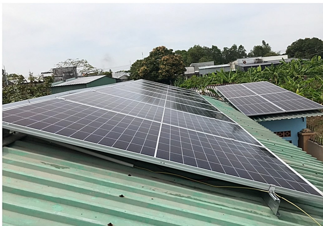
Dự án điện mặt trời áp mái 10 Kwp
