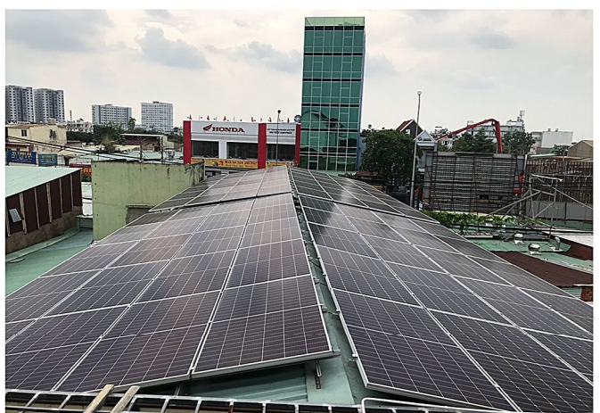
Dự án điện mặt trời áp mái 40 Kwp
