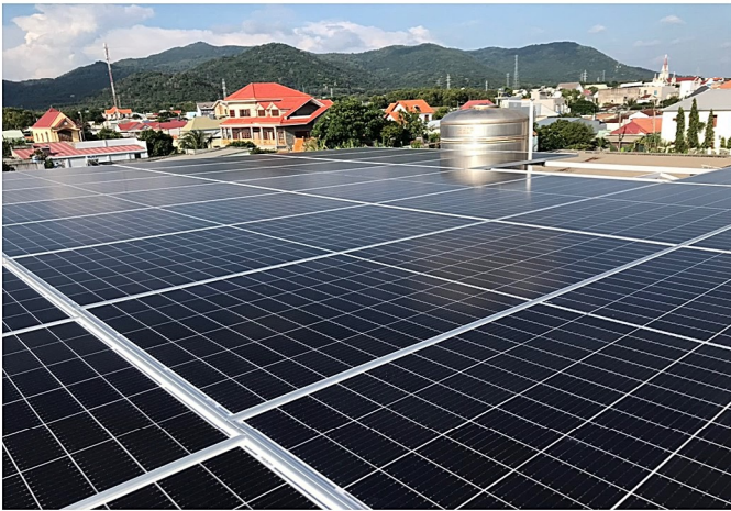
Dự án điện mặt trời áp mái 15 Kwp
