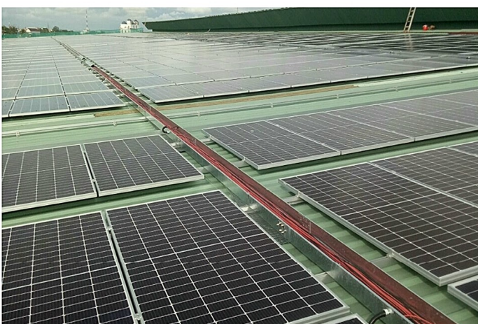
Dự án điện mặt trời áp mái 1 Mwp Công ty TNHH Đầu tư Đồng Tâm Solar
