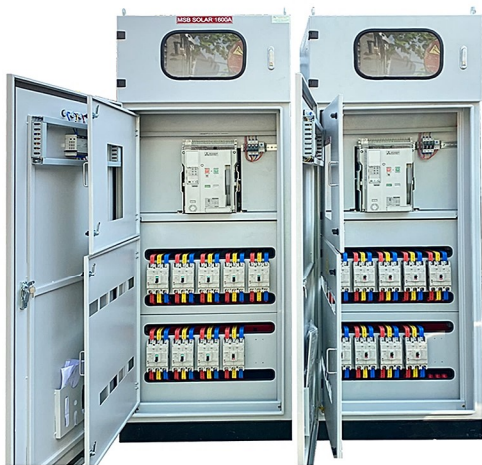
Tủ điện AC/DC
