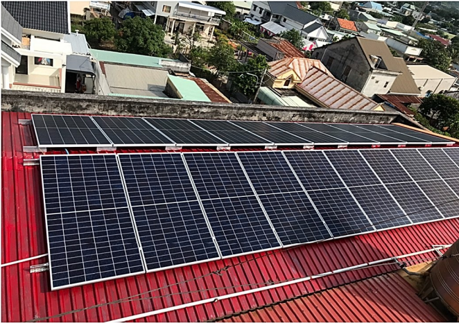
Dự án điện mặt trời áp mái 20 Kwp
