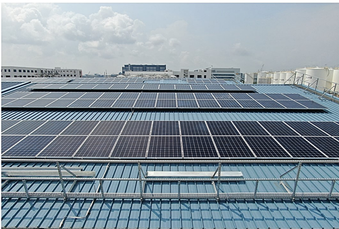
Dự án điện mặt trời áp mái 1 Mwp Công ty TNHH Đầu tư An Khang Solar
